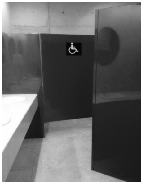
Figura 21. La colocación de los sanitarios “accesibles” hasta el fondo del local hace más compleja la función para usuarios de silla de ruedas
