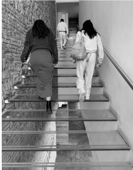
Figura 39. Escaleras flotantes como propuesta innovadora de la arquitectura contemporánea, mismas que generan incomodidad e inseguridad
