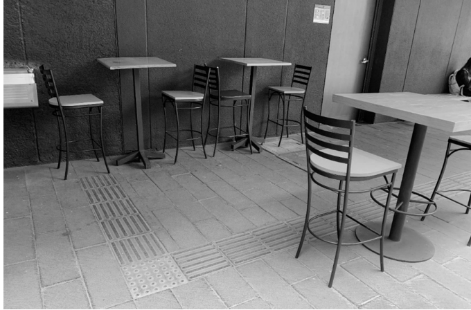
Figura 31. Losetas discontinuas, con boleados y colocadas sobre piso texturizado que confunde a las personas con discapacidad visual
